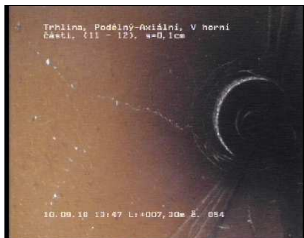
Foto 054 Videopáska 2: 1/8 Stav RL-O 7,30 m 11 - 12 Uhr Trhlina, Podélný-Axiální, V horní části, Šířka trhliny = 0,10cm
