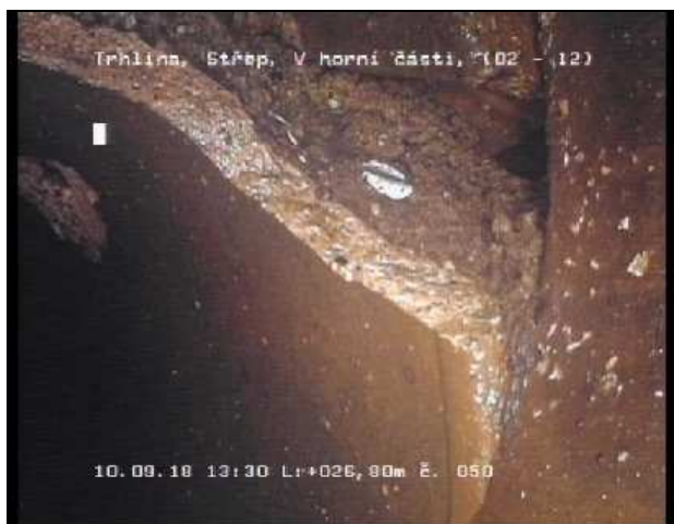
Foto 050 Videopáska: 1/7 Stav RS-O 26,80 m 2 - 12 Uhr Trhlina, Střep, V horní části
