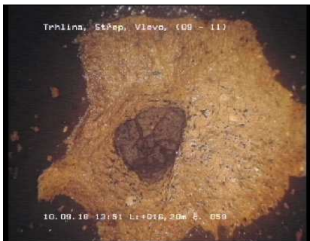
Foto 059 Videopáska 2: 1/8 Stav RS-L 16,20 m 9 - 11 Uhr Trhlina, Střep, Vlevo
