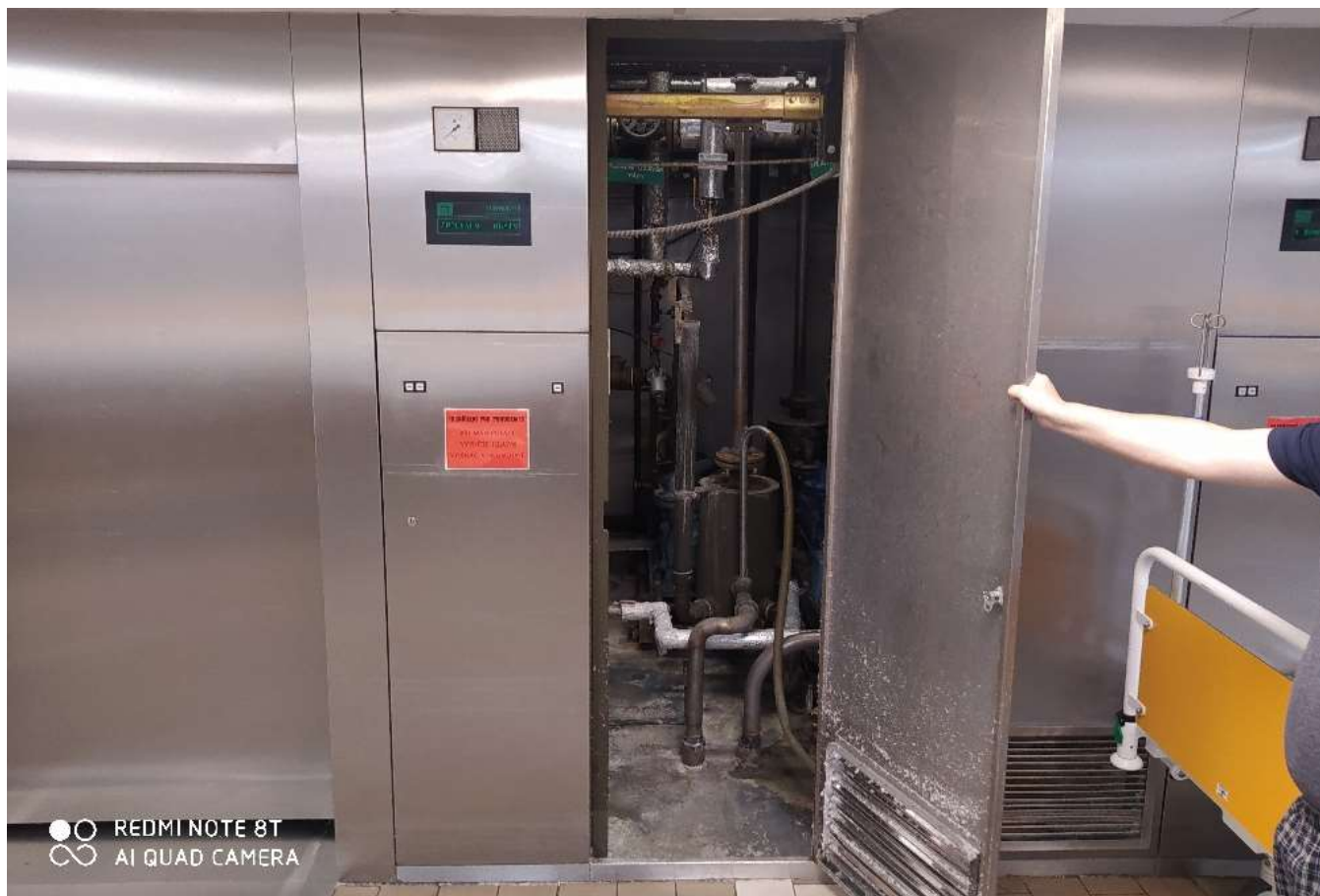
Stávající technologie – přístup k vnitřním rozvodů
