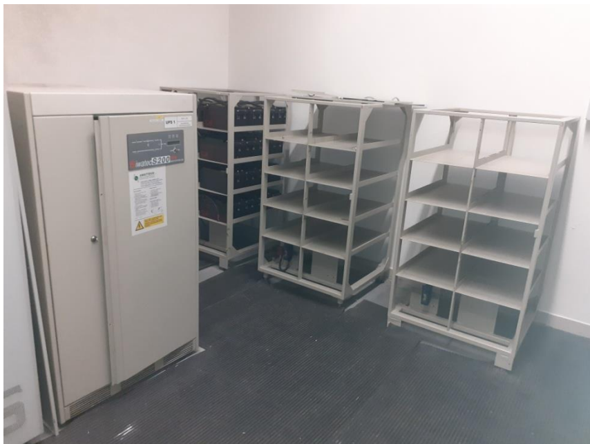
Celkový pohled na stávající (nefunkční) UPS
