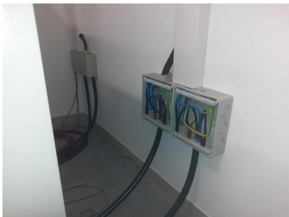
Propojovací krabice - umístěná na stěně za UPS
