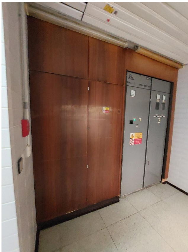
Obr.č.4 – Rozvaděč a obložení šachty m.č. 4047
